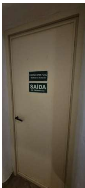
Foto 11 - Detalhe - Porta Corta Fogo
