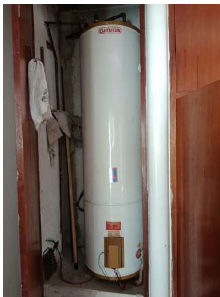
Foto 37 - Detalhe Boiler - Aquecimento
