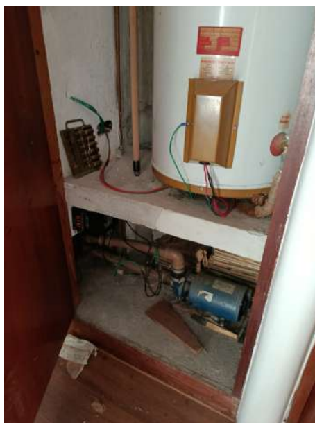
Foto 38 - Detalhe Boiler - Aquecimento
