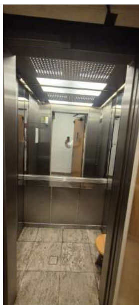
Foto 07 - Detalhe Elevador Social
