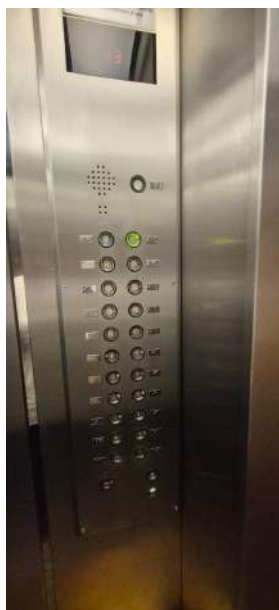
Foto 06 - Detalhe Elevador Social
