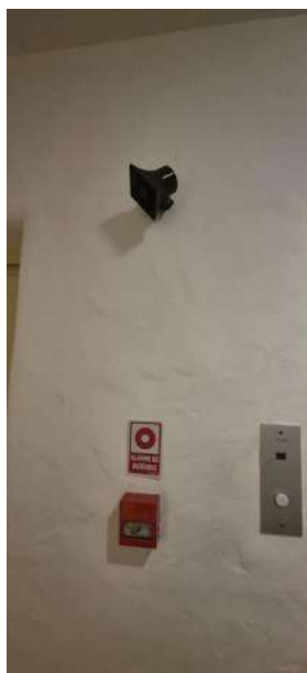
Foto 10 - Detalhe - Sistema de Incêndio
