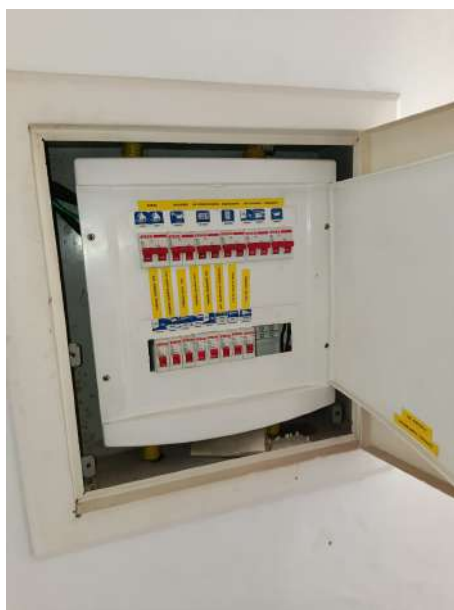
Foto 39 - Detalhe - Caixa de Distribuição
