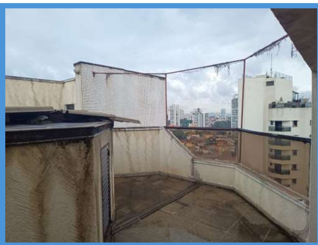
VISTA DA ÁREA EXTERNA A COBERTURA, COM MANUTENÇÃO PRECÁRIA.
