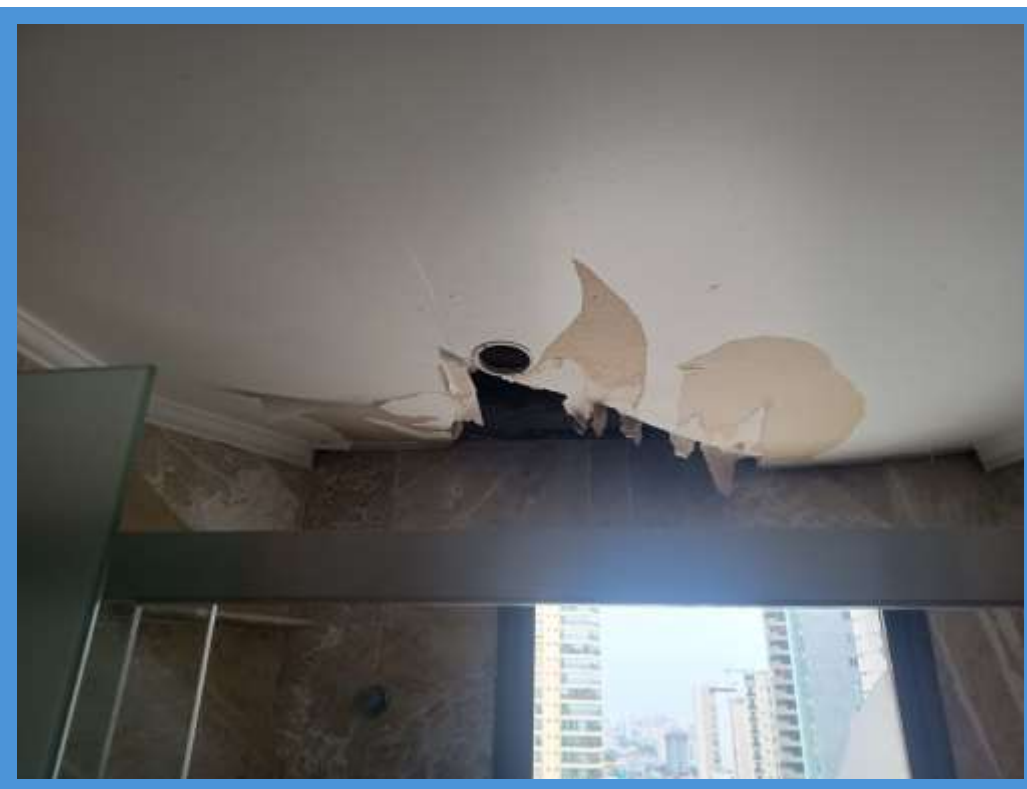
OUTRA VISTA DA SUÍTE DO 1º DORMITÓRIO, OBSERVANDO – SE A DETERIORAÇÃO EXISTENTE NO TETO NECESSITANDO DE REPAROS.
