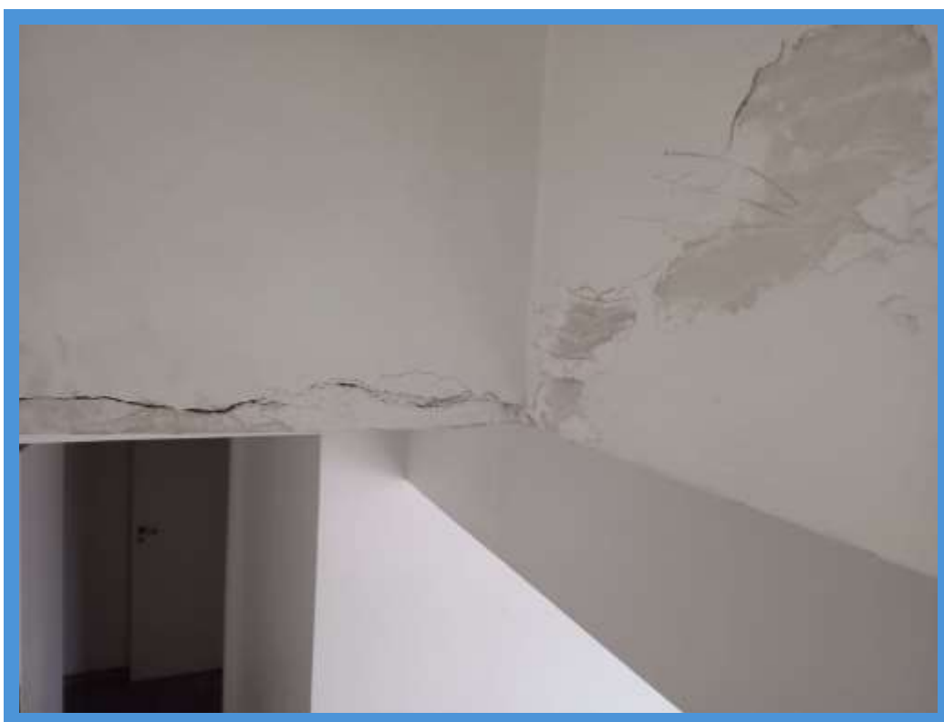
VISTA DA RACHADURA LOCALIZADA NO VÃO DA ESCADA QUE DÁ ACESSO À COBERTURA.
