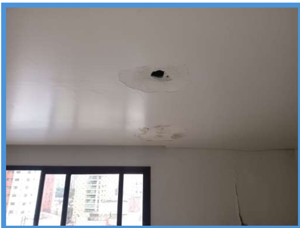
VISTA DO VAZAMENTO NA LAJE DA COBERTURA, POR INFILTRAÇÃO.
