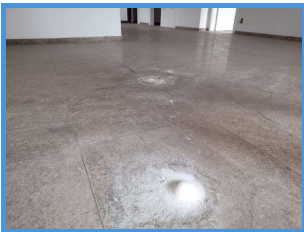
VISTA DA ESTALAGMITE PROVENIENTE DE INFILTRAÇÃO NA LAJE DA COBERTURA.
