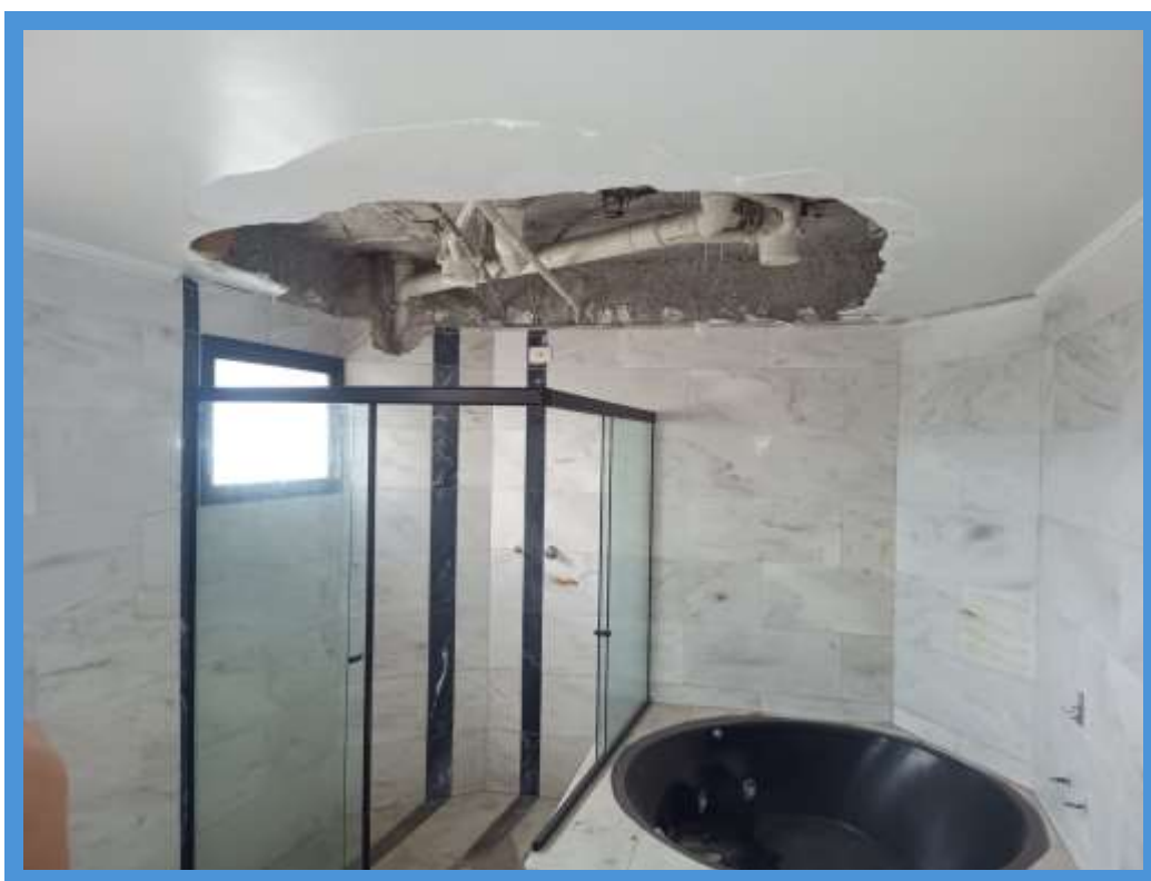
OUTRA VISTA DA SUÍTE MASTER, OBSERVANDO-SE A REFORMA DE MANUTENÇÃO HIDRÁULICA A SER REALIZADA.
