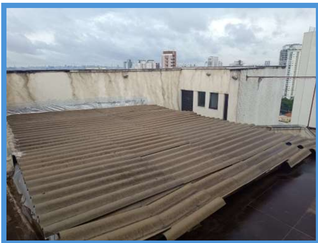
VISTA DA PISCINA INUTILIZADA NA ÁREA EXTERNA DA COBERTURA, DEVIDO A INFILTRAÇÃO QUE A MESMA ESTAVA CAUSANDO NO IMÓVEL.
