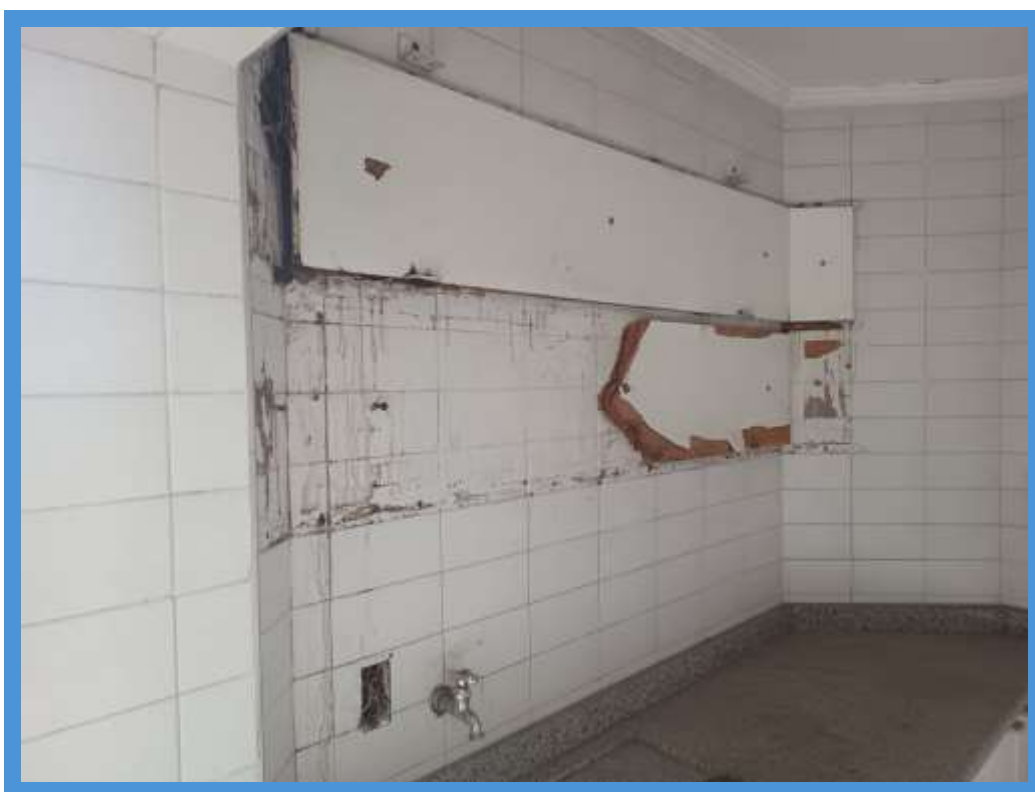
VISTA DA ÁREA 'GOURMET' PERTENCENTE A COBERTURA, COM MANUTENÇÃO PRECÁRIA.
