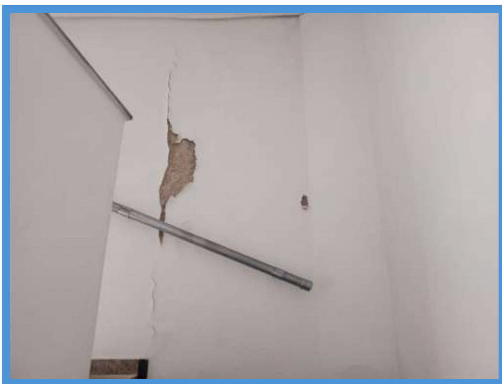
VISTA DA ESCADA DE ACESSO À COBERTURA DO IMÓVEL, OBSERVANDO-SE RACHADURA DEVIDO A INFILTRAÇÃO.
