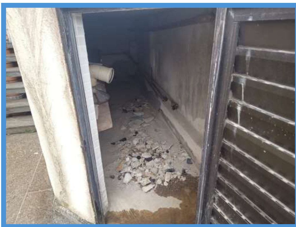
VISTA DA CASA DE MÁQUINAS PERTENCENTE A PISCINA, INUTILIZADA.
