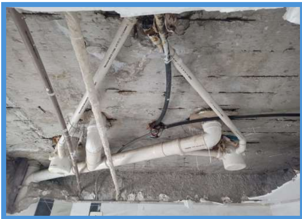
VISTA DO TETO DA SUÍTE MASTER, OBSERVANDO - SE A MANUTENÇÃO/REFORMA A SER FEITA. AS FERRAGENS DA LAJE ESTÃO EXPOSTAS.
