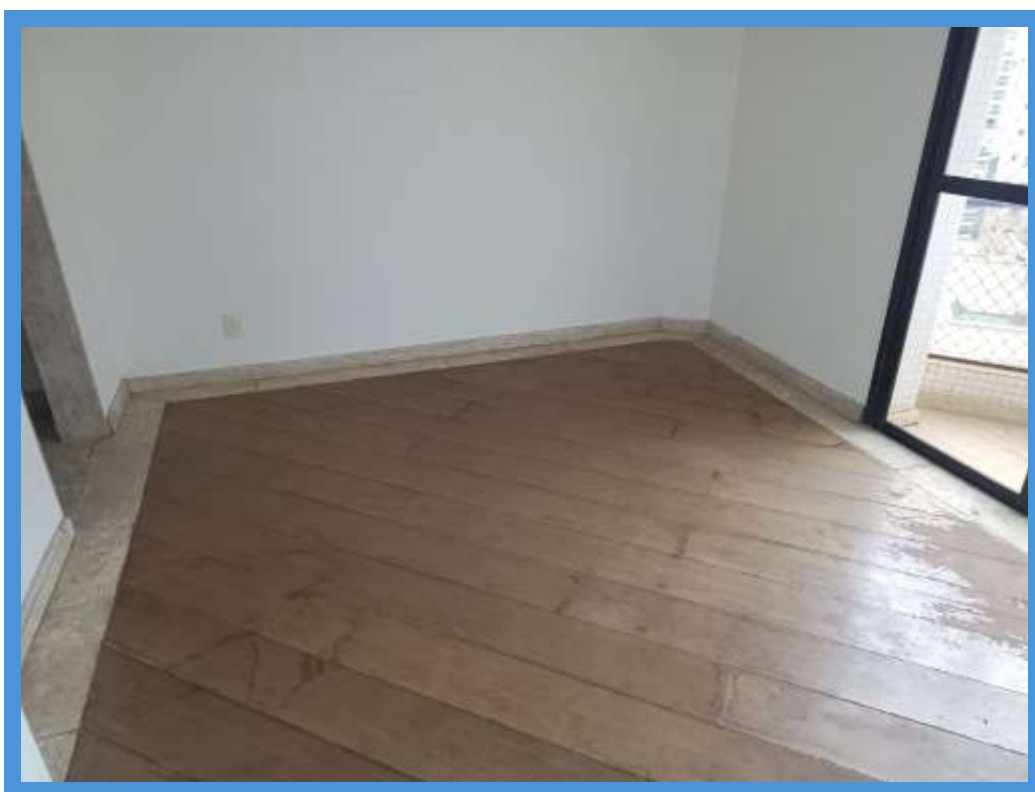
OUTRA VISTA DO DORMITÓRIO MASTER COM SUÍTE, COM PISO DEGRADADO.
